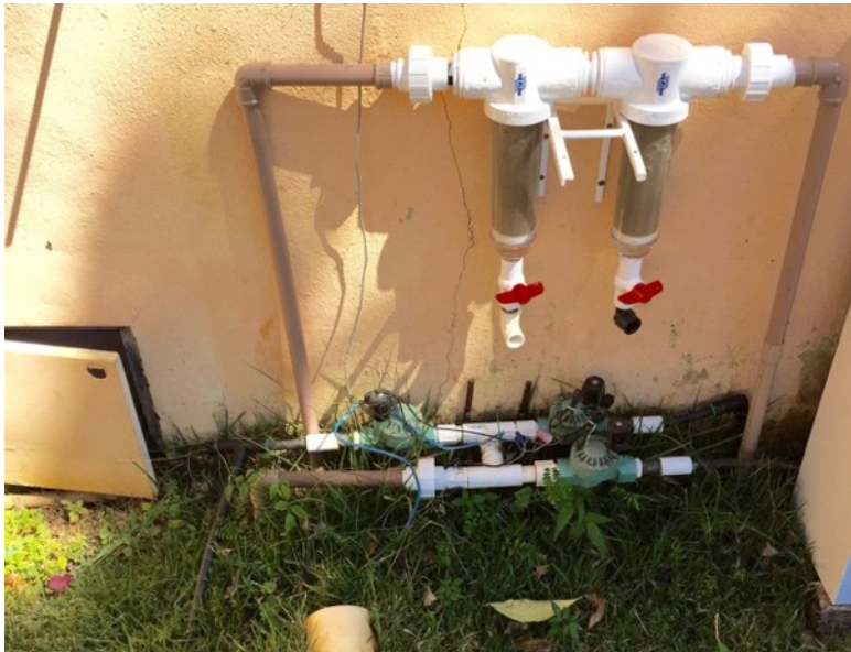
Foto 2: Filtros de água de irrigação (200 Mesh)
